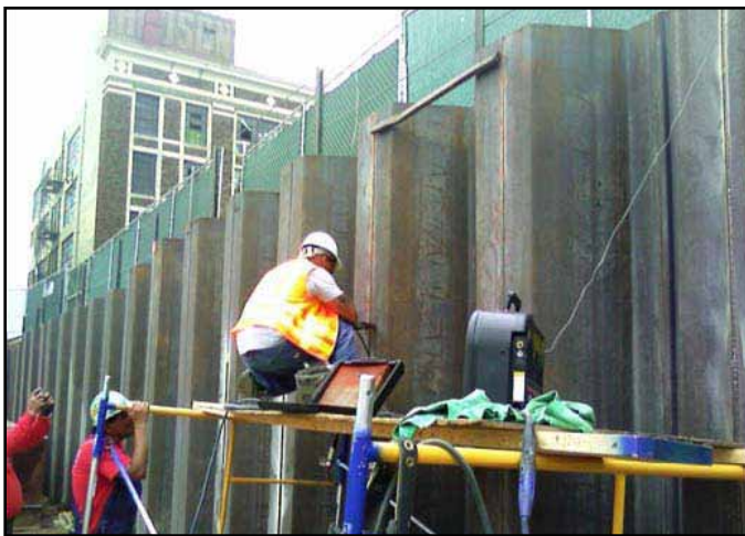
Figura 9: Pruebas con partículas magnéticas después del soldado de los pilotes de plancha
