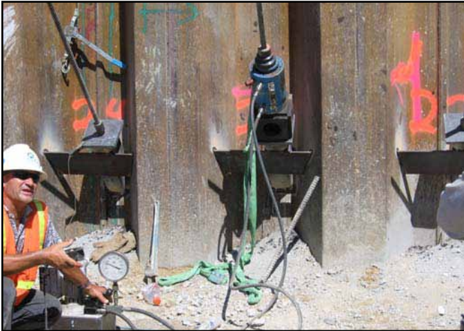
Figura 12: Instalación y tensado de los tirantes en los pilotes de plancha dentro de la zona convencional
