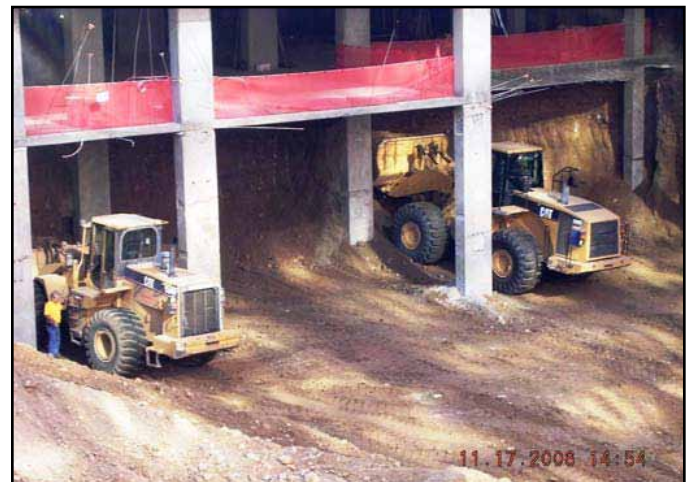
Figura 5: Excavación de socavado por debajo de la losa P1
